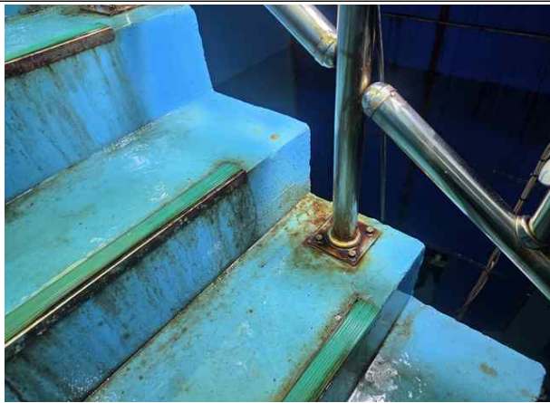
손상내용 1지 계단 녹물 손상원인 공용열화
