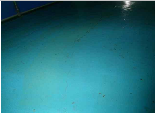
손상내용 1지 바닥슬래브 균열 손상원인 건조수축
