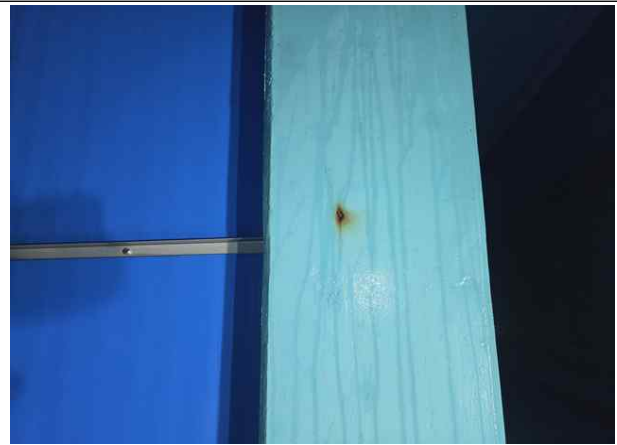
손상내용 1지 기둥 녹물 손상원인 피복부족
