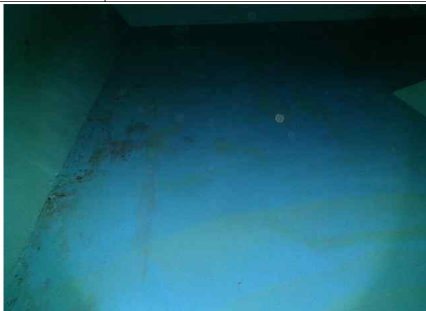
손상내용 1지 바닥슬래브 도장손상 손상원인 공용열화
