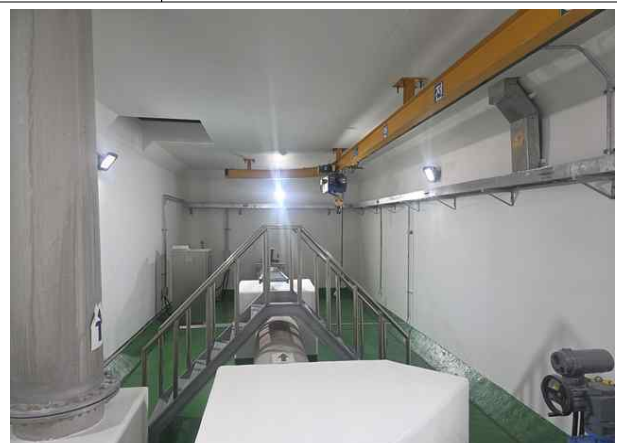
손상내용 유출밸브실 배관 양호 손상원인 -
